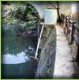
浄化装置の設置状況(90k)
